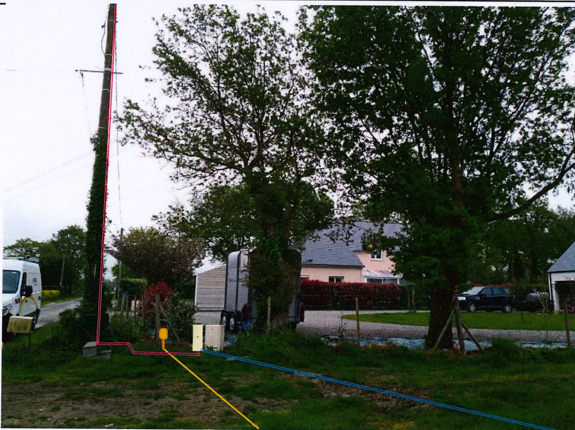
La solution technique est déterminée dans le respect de la norme NFC 14-100 en vigueur. Photo compteur non contractuelle
